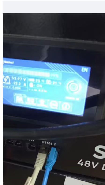
Afișaj BMS și conexiune RS485 vizibilă
